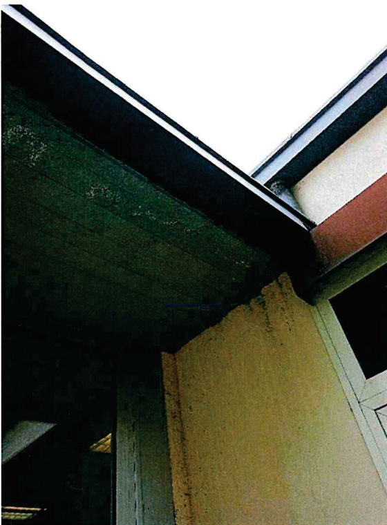
Foto 12 – caduta frammenti calcestruzzo
